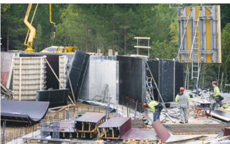
PÅ GÅNG. Bygget börjar ta form, och det syns det att det är ett udda hus med böjda väggar som byggs.
