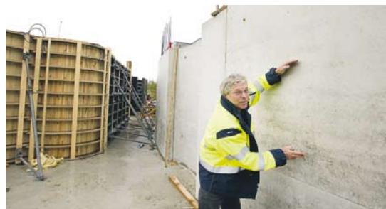
EN BIT I SÄNDER. Thomas Holgersson mättar hur mycket betong som går att fylla på i taget för att slutresultatet ska bli bra.
